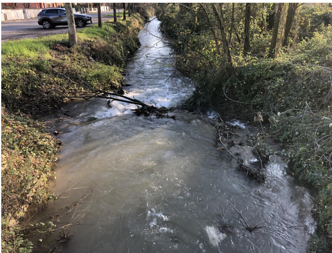
9B - Detriti e depositi vegetali su briglia o salto morfologico in alveo della roggia Lisso.
