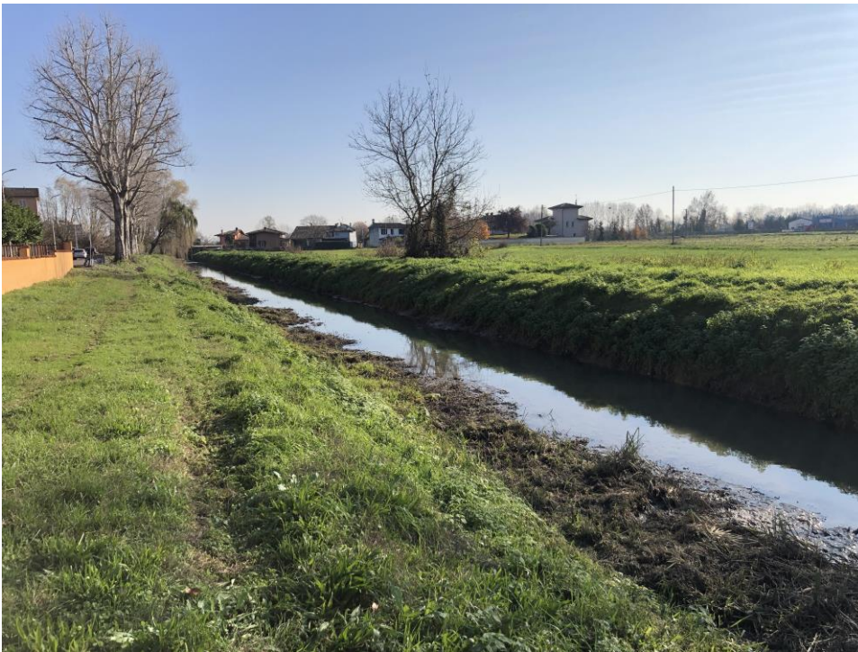
5A – Cedimento spondale su colatore Serio Morto lungo via Ferravilla.
